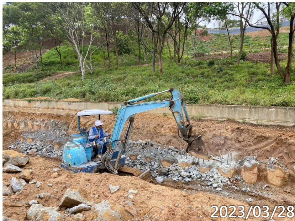
樁頭劣質打除
