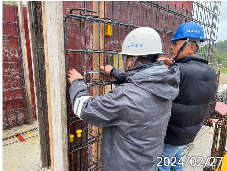
女寮2區1F水電配管
