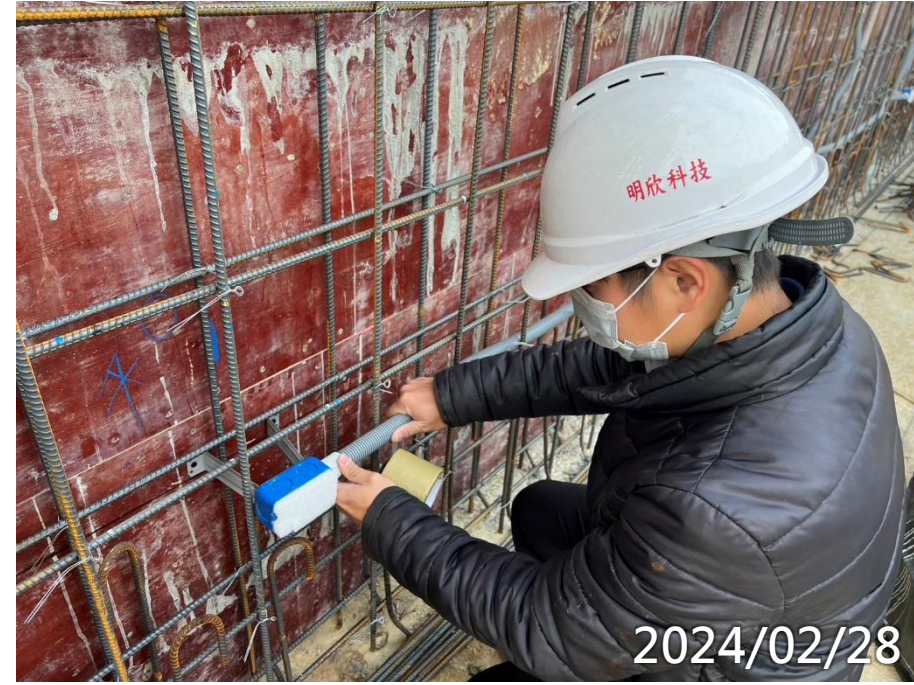
女寮2區1F水電配管
